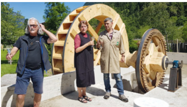
Das Mühlrad im Gerinne des neuerbauten Mühlengebäudes auf dem Gelände des Biohotels Stillebach.
